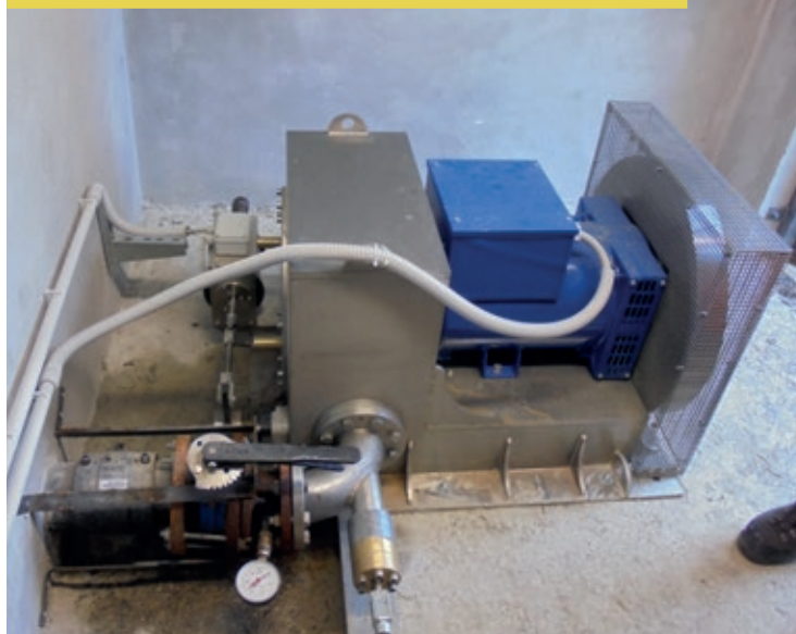
Centralina elettrica in funzione - Fossernica di fuori
