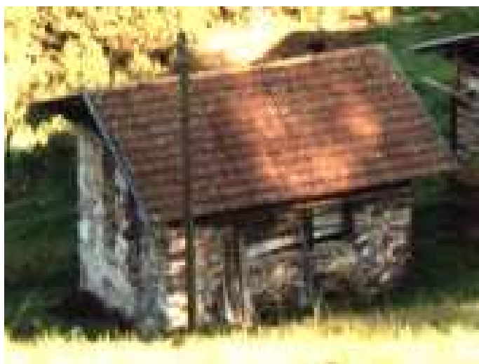
Fotografia anno 2002 (pre risanamento)
