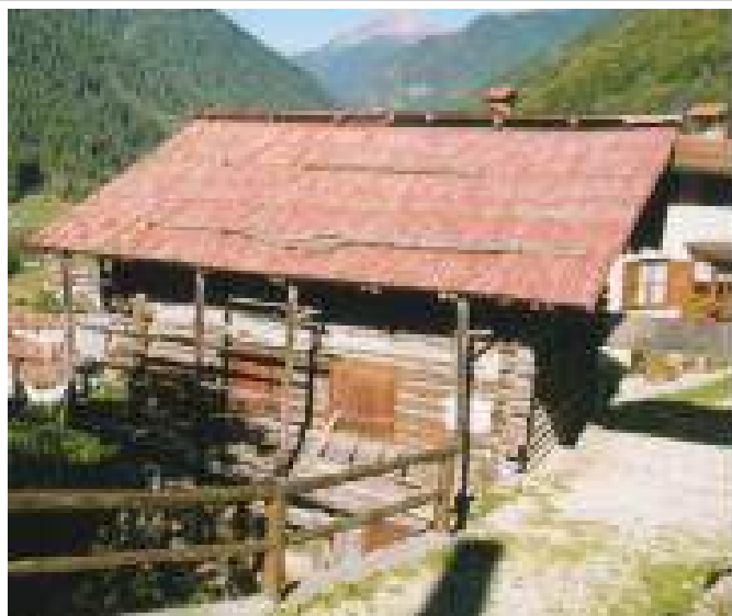
Fotografia anno 2002 (pre risanamento)
