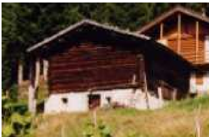
Fotografia anno 2002 (pre risanamento)
