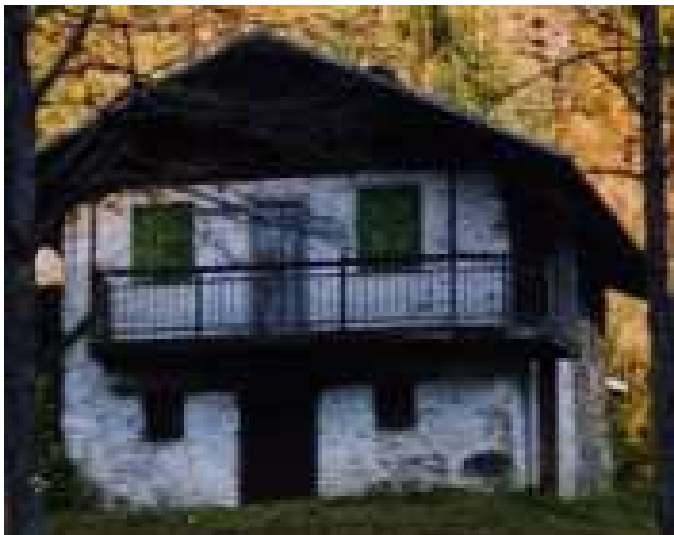
Fotografia anno 2002 (pre risanamento)
