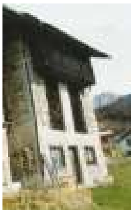
Fotografia anno 2002 (pre risanamento)
