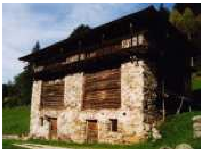
Fotografia anno 2002 (pre risanamento)
